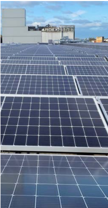
PV-Anlage bei ARDEX in Witten, Deutschland
