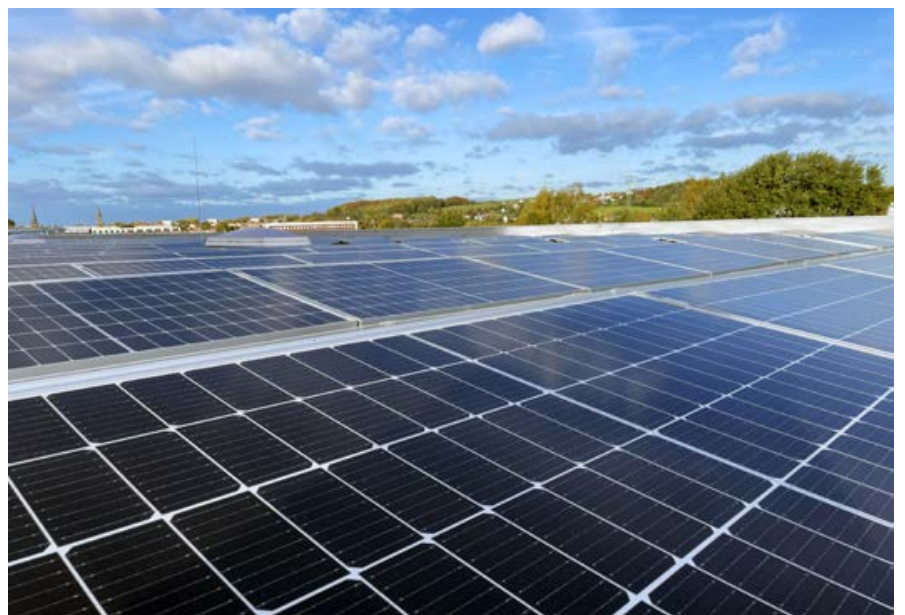
ARDEX-Photovoltaikanlage in Witten, Deutschland
