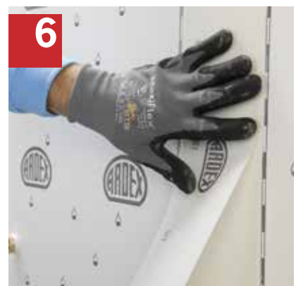
6 Stöße mit ARDEX SK 12 Dichtband und ARDEX AF 181 W abdichten. Es ist darauf zu achten, dass ARDEX AF 181 W deckungsgleich zur Breite des Dichtbands aufgetragen wird.
